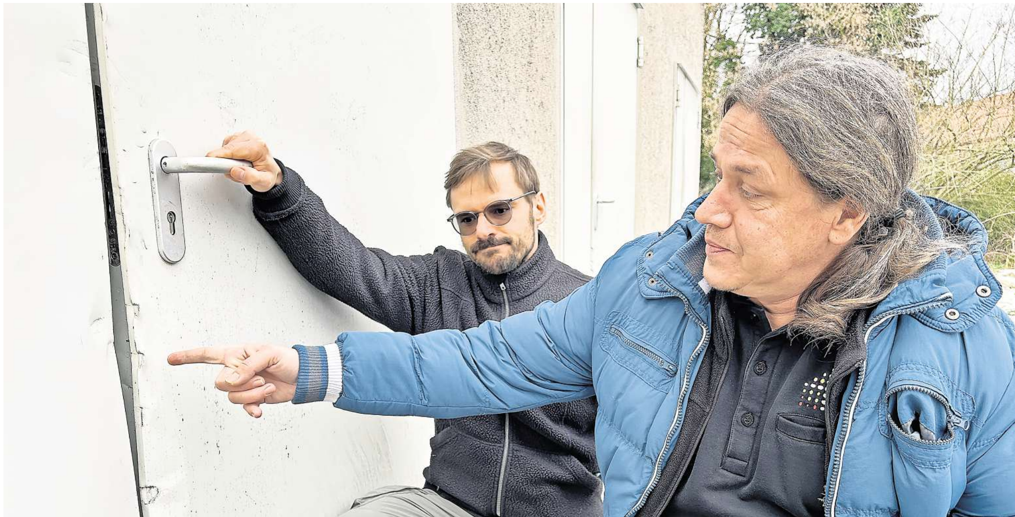
Friedhofsverwalter Paul Schütz (l.) und sein Stellvertreter Norbert Krüger inspizieren die aufgehebelten Stahlschutztüren zur Garage.
